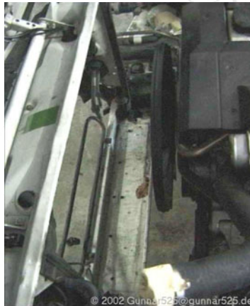
Abbildung 6: Nach Ausbau Klima- und Wasser- Kühler
